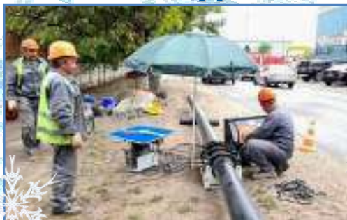
РЭУ «Ейский групповой водопровод»
