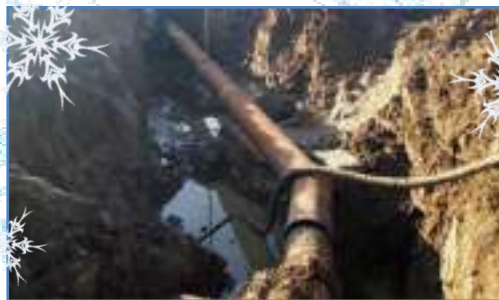
РЭУ «Таманский групповой водопровод»
